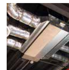
Unidad de renovación del aire
